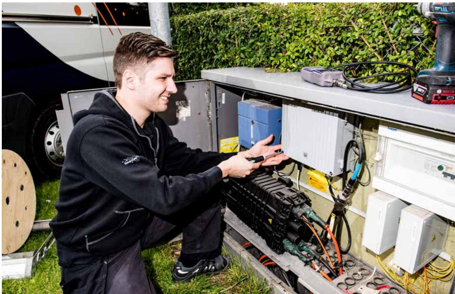
Tekniker David Bendix Endersen er her i gang med justering af coax-udstyr i teknikskab.
