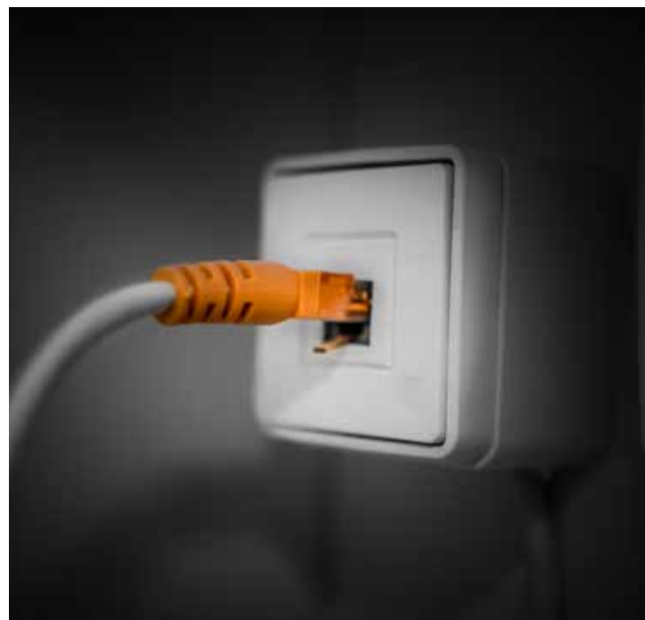
PDS-installation, som bl.a. benyttes i boligforeninger.
