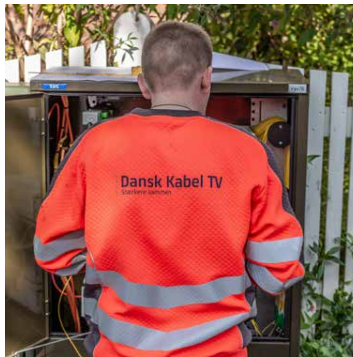
Tekniker Tim Christiansen arbejder ved hovedfordelerskab i Lyngby.
